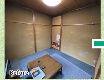
砂壁が傷んでるし……ボロボロ落ちていともあるし……
